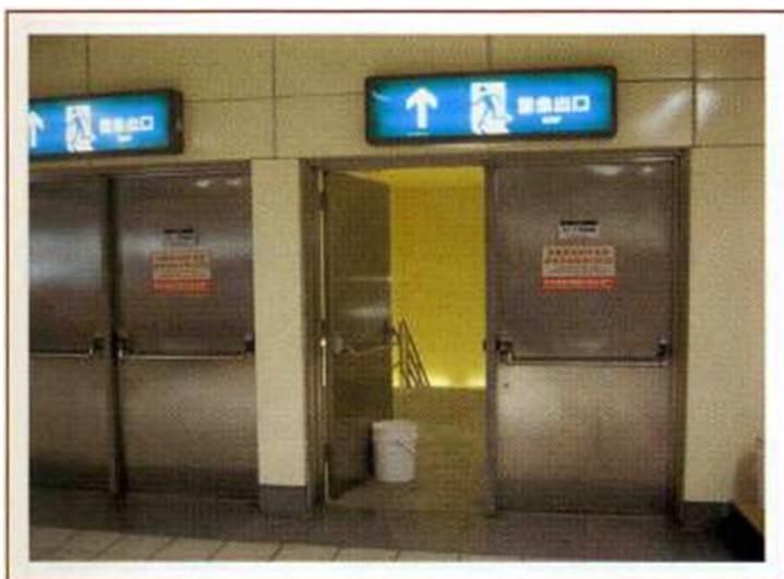
▲ 常時關閉式防火門案例，該類門扇應免 用鑰匙即可開啓，且不得設置門止。
