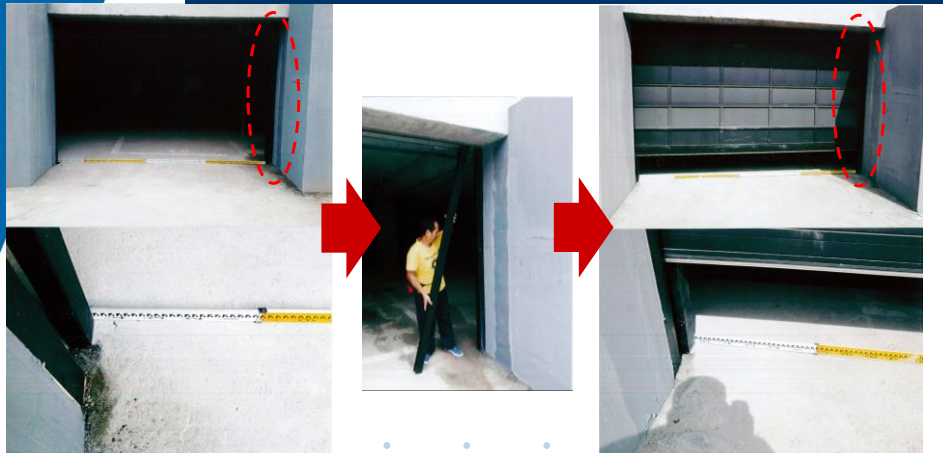
改善前照片，門框造成淨寬不足
