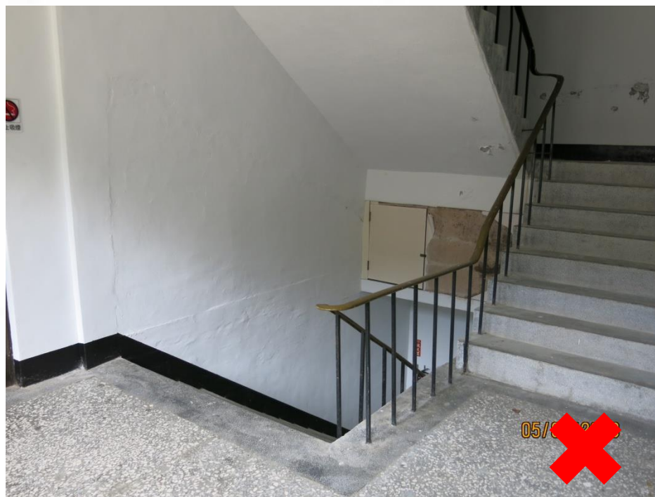
■樓梯未設置雙邊扶手及終端警示
