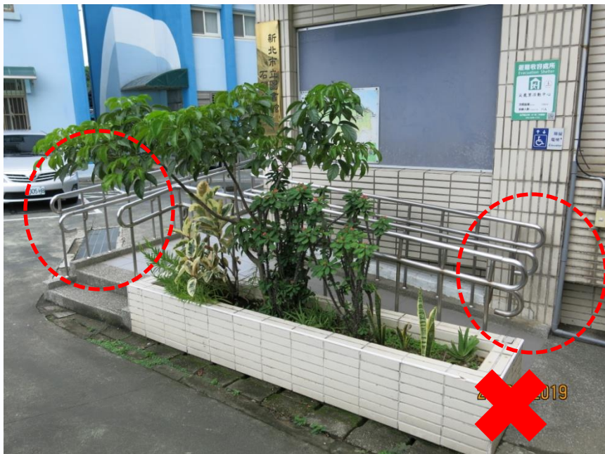
■坡道扶手未做防勾撞處理
