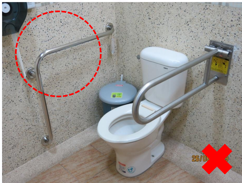
■無障礙廁所扶手安裝錯誤
