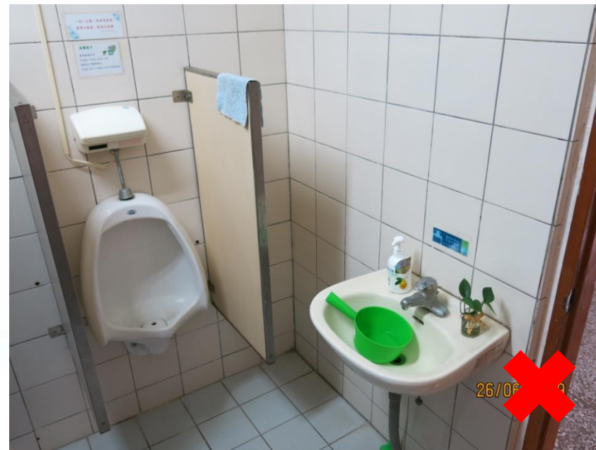
■未設置無障礙小便器 洗手台扶手、明鏡未安裝
