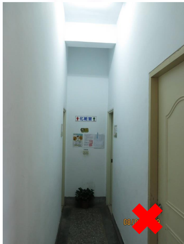
■室內通路寬度未符規定
