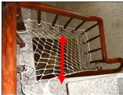
圖9 樓梯與階梯間縫隙超過30公分
