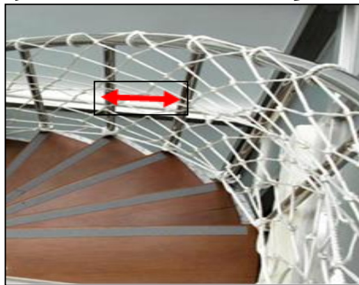
圖11 欄杆間隔超過10公分
