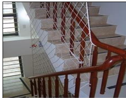
圖10 樓梯間加裝防墜網
