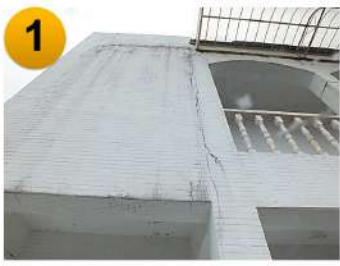
1 梁柱裂縫寬度超過0.03公分(筆尖可深入)，或鋼筋外露、樑柱歪斜
