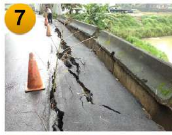
7 道路路面出現明顯裂縫且局部陷落
