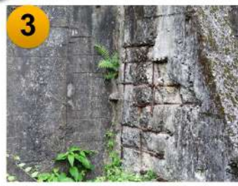
3 擋土牆鋼筋外露、鏽蝕或產生裂縫(原子筆芯頭可深入)
