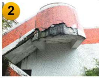
2 建築物壁體磁磚、粉刷層大量剝落
