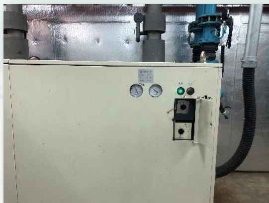
空調系統-冰水主機
