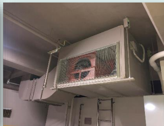
通風系統-抽排風機
