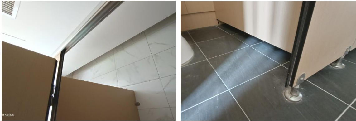
圖六 廁間隔板距天花板及地板仍有空隙
